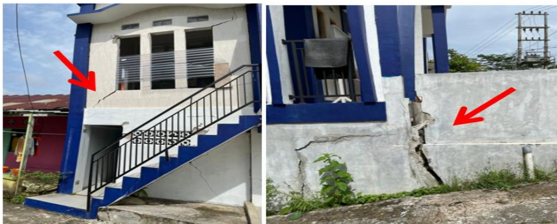
Gambar 1 Kerusakan akibat tanah yang bergerak pada bangunan mushola di Jalan Padat karya Km 8 Kelurahan Graha Indah
