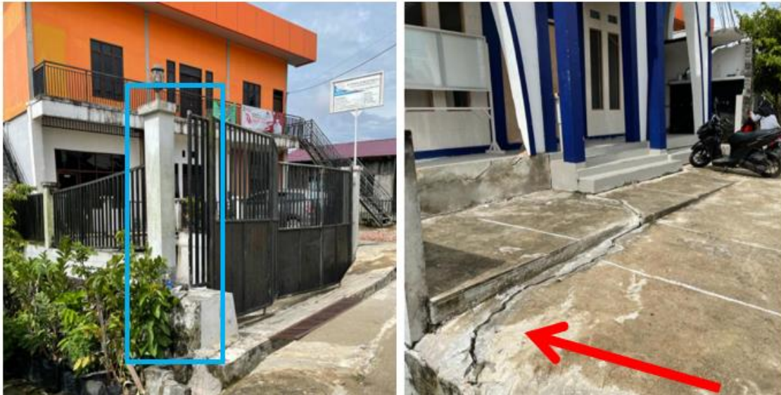
Gambar 2 Kerusakan pada pagar rumah warga dan jalan yang retak akibat gerakan tanah
