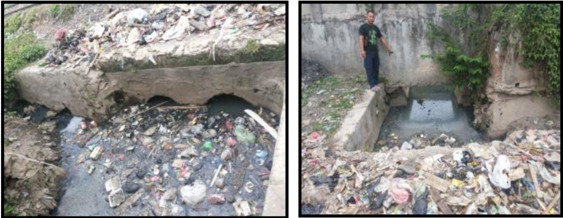
Gambar 1.5. Kondisi Saluran Pembuangan Air diKelurahan Pidada
